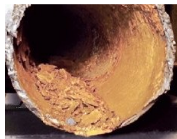
รูปที่ 2.3 ลักษณะการกัดกร่อนแบบ Uniform Corrosion
